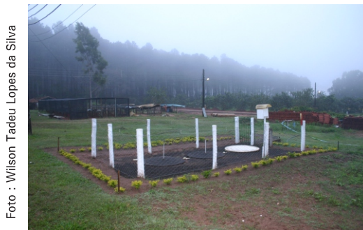
Figura 1. Fossa Séptica Biodigestora Instalada na ETEC Astor de Mattos Carvalho, em Cabrália Paulista, SP.
